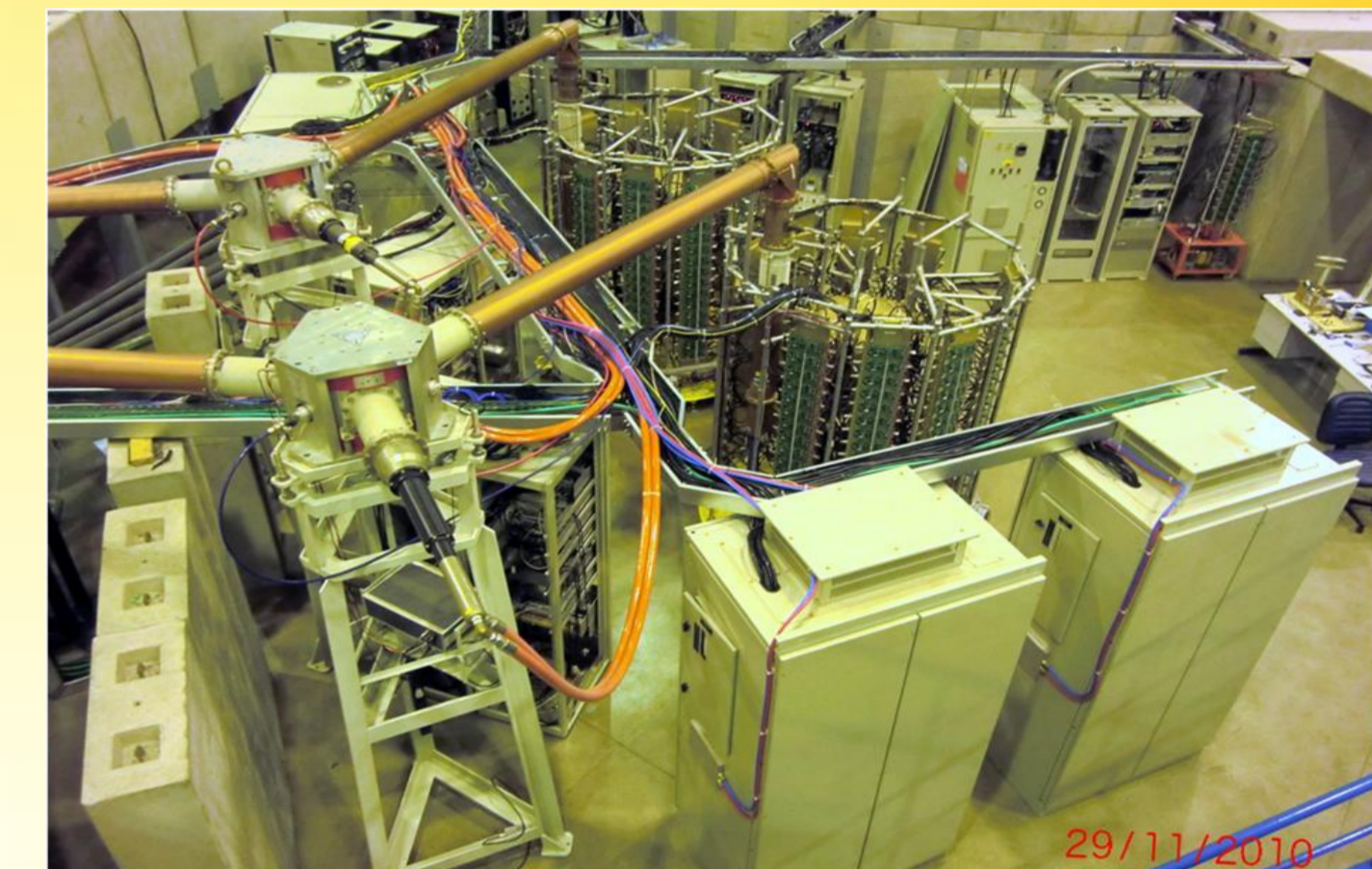
Les 2 amplis 50 kW installés sur l'AS de LNL, où ils fonctionnent parfaitement depuis 5 ans
