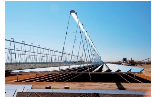
Centrale à concentrateurs linéaires de Fresnel
