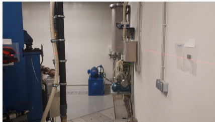
Détecteurs passif sur murs de la casemate
